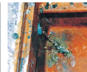
排水樹への排水状況
