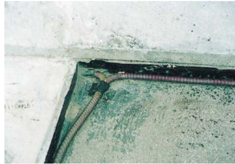
流末処理:伸縮装置後打コンクリートに埋め込み 遊間部に誘導した耐圧ホースに接続
