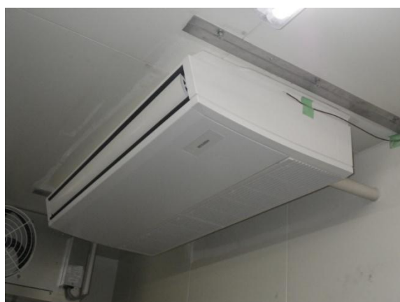
写真 2 低温用エアコン（左）と中温用エアコン（右）
